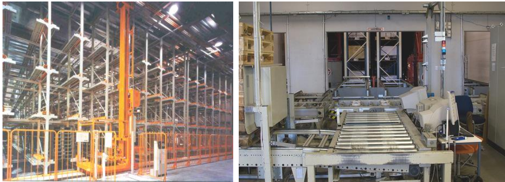
Fig. 8.7. Shembuj të depove të automatizuara
