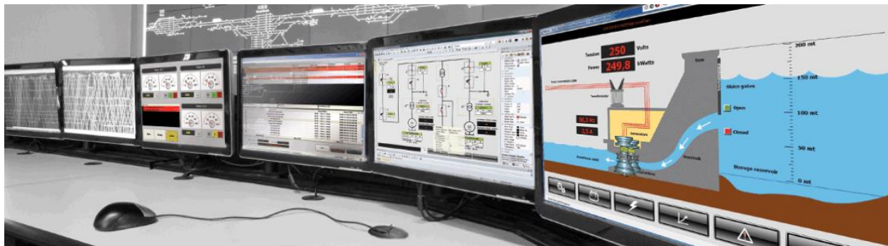
Fig.5.7. Qendrat e kontrollit dhe monitorimit
